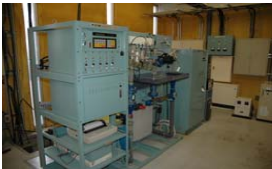
水質自動監視装置
