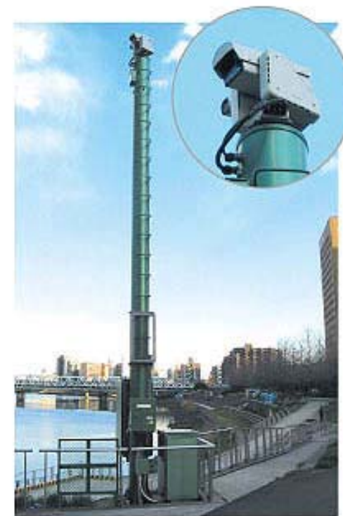
CCTVカメラによる状況把握
