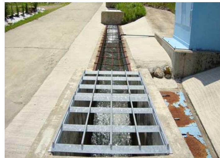
▲ 発電所設置後の現況
