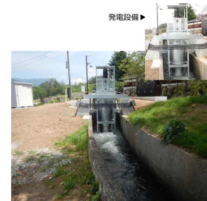
▲発電所設置後の現況
