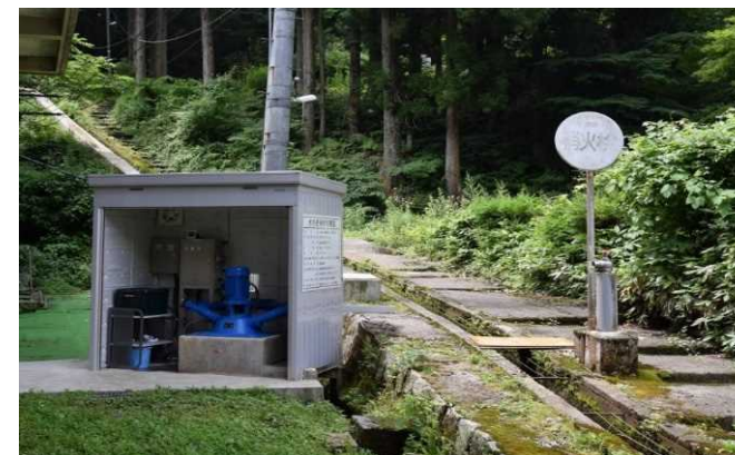
▲ 発電所設置後の現況
