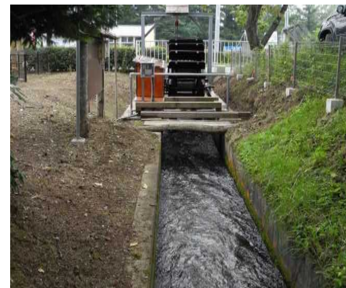
▲ 発電所設置後の現況
