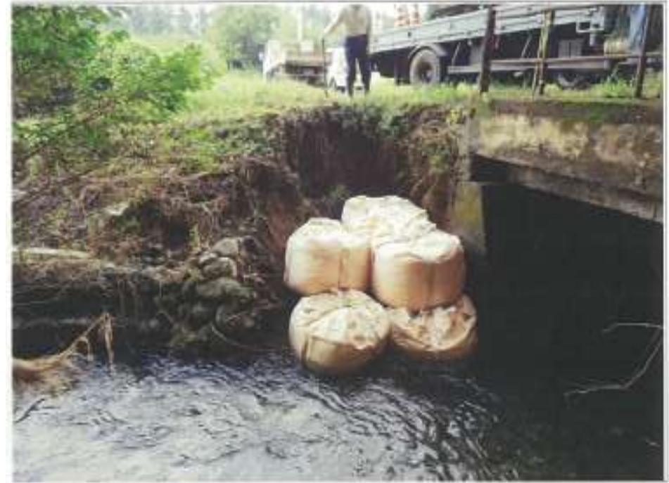
崩壊部分全体が土のうでカバーできていない
