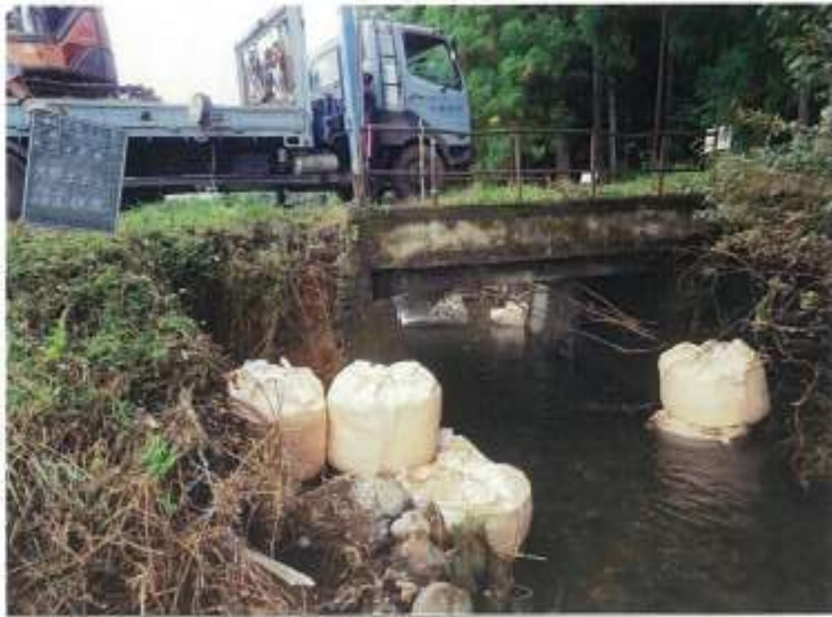
土のうの積み方が粗雑であり、数も不足している
