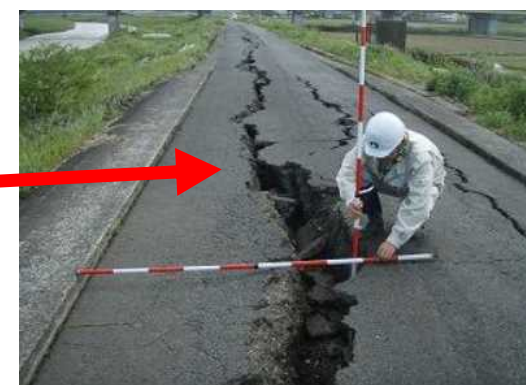
堤防天端に生じた大きな亀裂と段差
