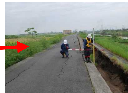
堤防天端の沈下状況
