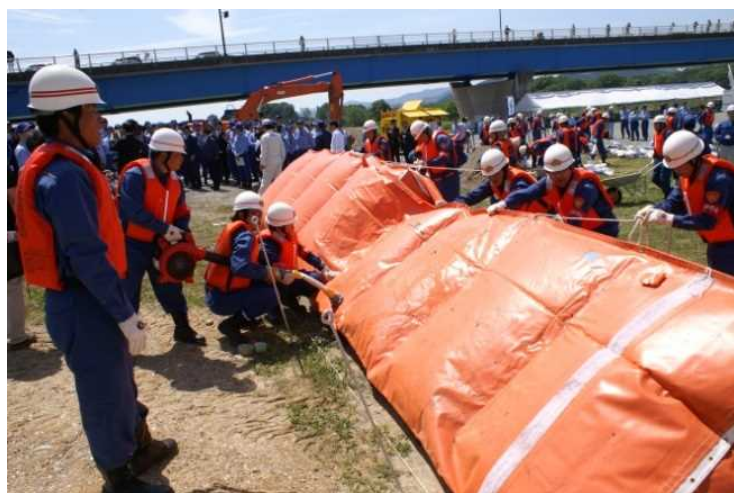
京丹波町：越水止め水のう工
