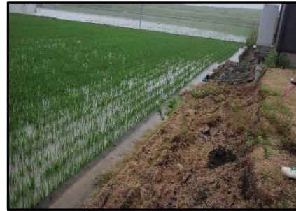
塩屋地区住宅敷地一部崩落
