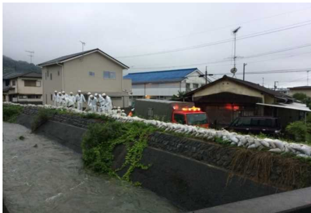
中山川水系大谷川 における 水防活動実施状況 (南側から撮影)
