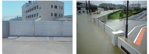
止水版の設置による浸水防止効果発揮事例
