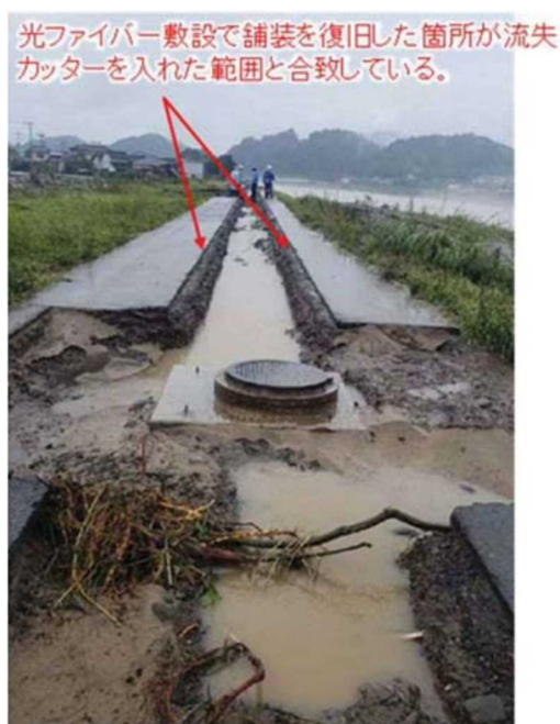
写真 2.3-6 被災箇所の舗装の流失の状況（その1）
