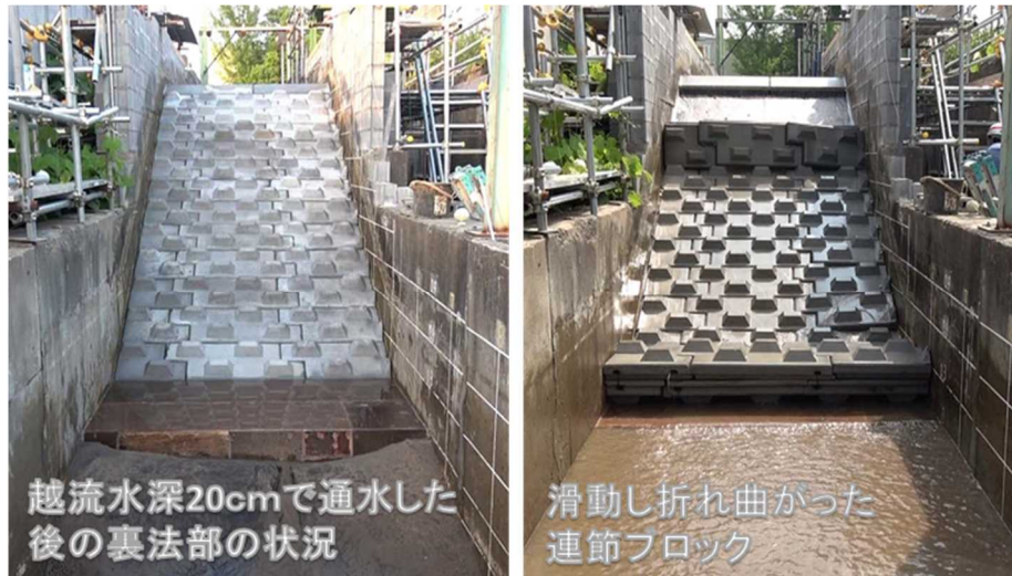
写真 5.4-2 被覆ブロックが折れ曲がった事例
