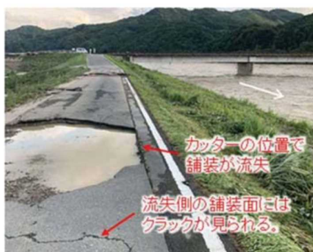
写真 2.3-7 被災箇所の舗装の流失の状況（その2）
