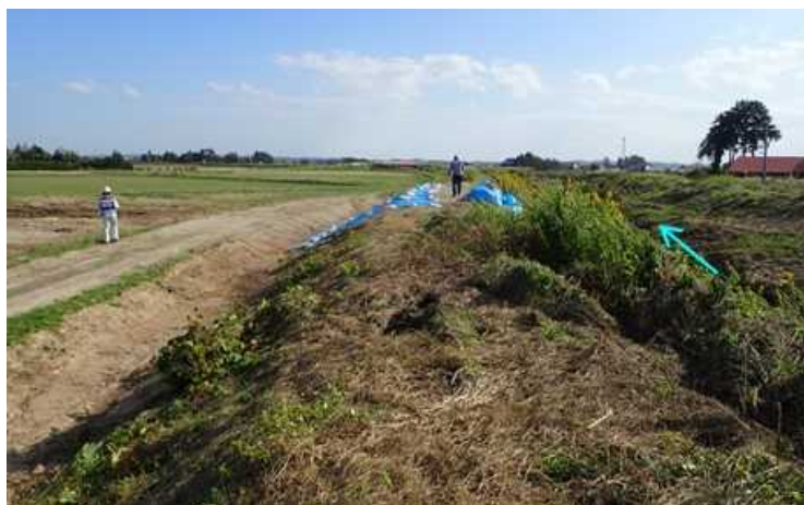
写真 2.3-1 名蓋川左岸決壊箇所付近の侵食状況
