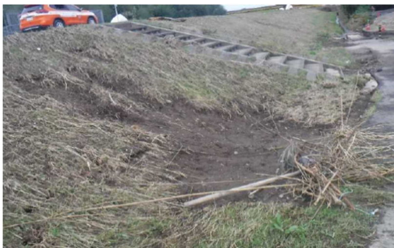
写真 2.3-2 那珂川左岸 19.5k 付近の侵食の状況
