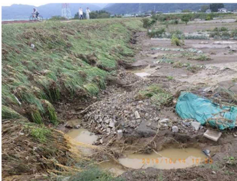
写真 2.3-3 千曲川左岸 79.0k 付近の侵食の状況
