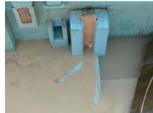
写真-①融雪期放流設備が閉まっている状態
