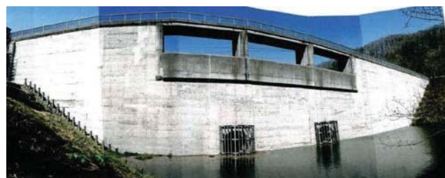
図 1.3-4 凍結融解による劣化に対する再補修の事例
