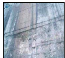
スケーリング
