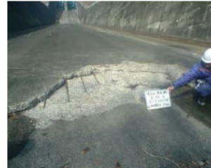
劣化・損傷状況
