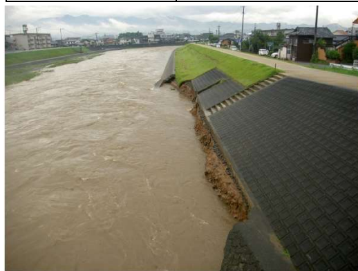
護岸崩壊状況
