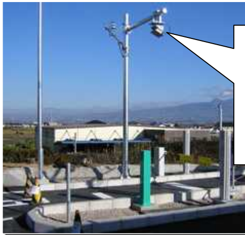
路側無線装置 (DSRCアンテナ)
