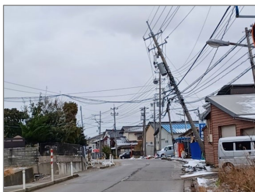
図 39 電線の傾斜 (内灘町)
