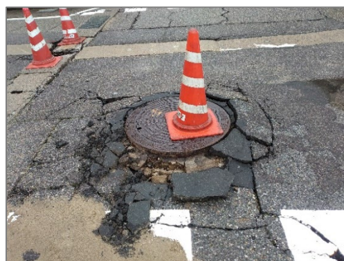
図 40 マンホールの浮き上り (氷見市)
