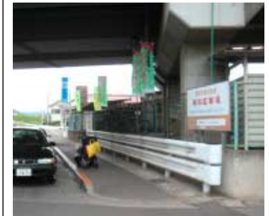
鉄道高架橋の橋脚保護のために防護柵が設置されたと考えられる例 橋脚は、防護柵の柵高と同程度の一段高い構造物上にあるため防護柵は必ずしも必要ない
