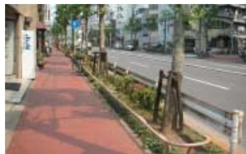
錆や汚れが目立つ防護柵の例
