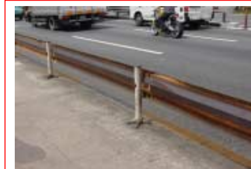
錆が目立つ防護柵の例
