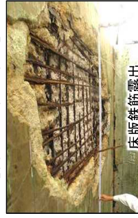
【橋梁の老朽化事例】
