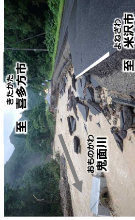
国道121号 令和4年8月の大雨
