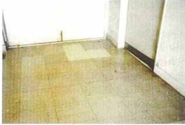
写真 3—9 内装材の使用例
