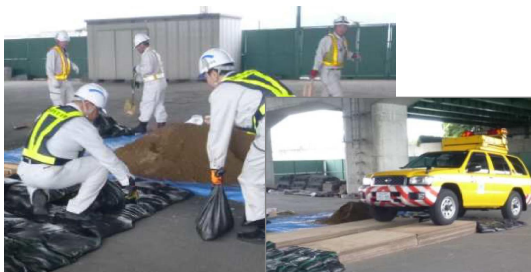
岡山管理センター
