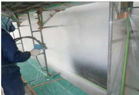
門崎高架橋の塩害対策
