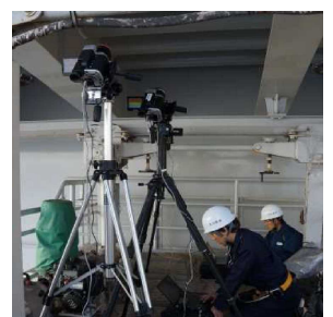
疲労亀裂の遠隔検出手法の開発
