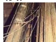
ケーブル素線の 破断事例 (海外の橋梁)
