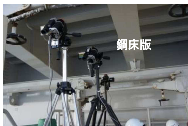
赤外線サーモグラフィを用いた亀裂の検出
