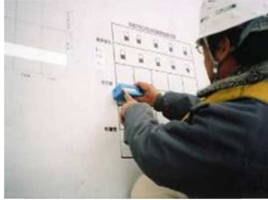
塗装劣化状況の調査
