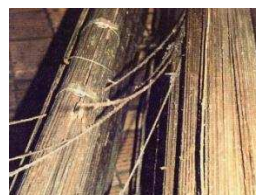
ケーブル素線の破断事例(海外の橋梁) システム導入前の吊橋では、劣化が進行
