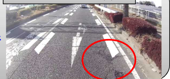
国道50号での局所劣化箇所例
