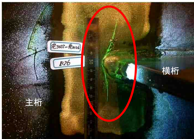
鋼桁 クラック
