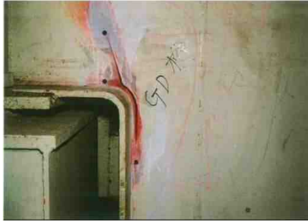
鋼桁切欠部のクラック
