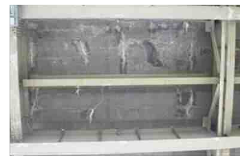
床板のひび割れ
