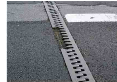
伸縮継手の損傷
