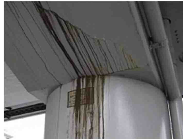
RC橋脚 ひび割れ
