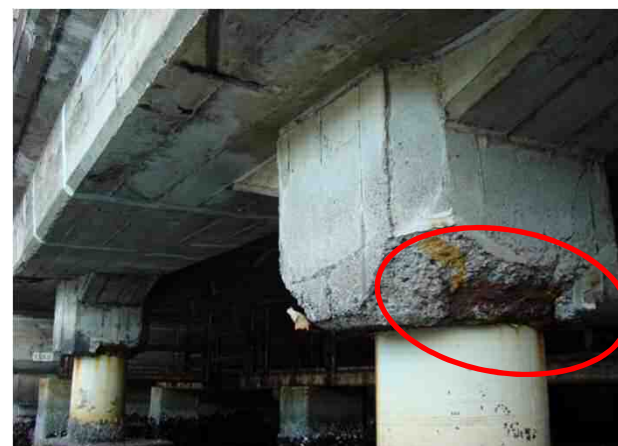
杭頭部 鉄筋露出
