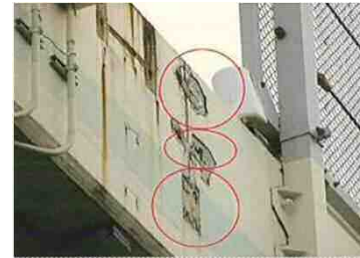
コンクリートの剥落
