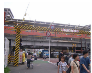
現在の状況(対策実施中)
