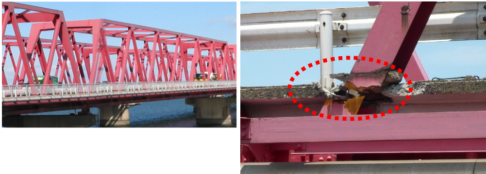
トラス橋の斜材の破断
