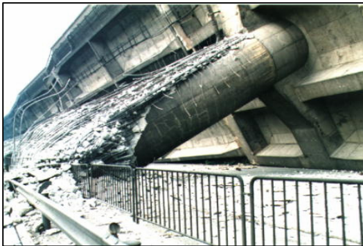
【阪神・淡路大震災により倒壊した橋梁】
