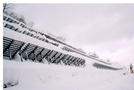
【雪崩予防柵による雪崩対策】
