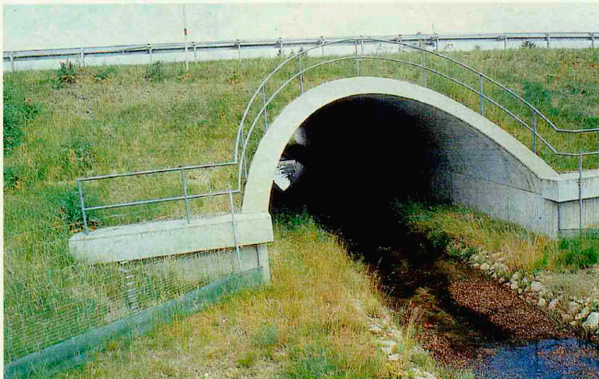
○小動物の通路を兼ねたトンネル（ドイツのアウトバーン）
