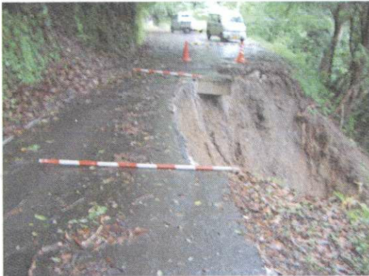
大雨による路側崩壊（馬路村 河平）
