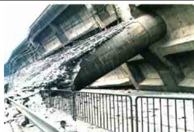
兵庫県南部地震では、橋梁の被災により救援活動や緊急物資輸送に多大な影響を及ぼした。
