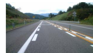
[導流レーンマーク]
