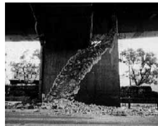
【兵庫県南部地震による橋脚の被災】
