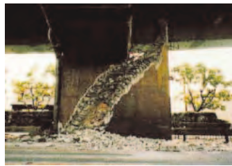
【兵庫県南部地震による橋脚の被災】
