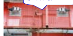
落橋防止装置が作動し、桁の移動を防止
