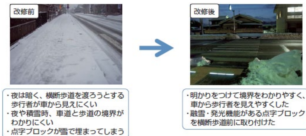
図 2-5 融雪・発光機能付き視覚障害者誘導用ブロックの設置（基準適用外）
