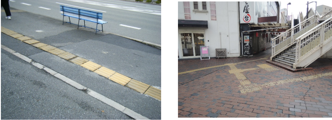
写真 5-1 経年使用によりガタつきや剥がれが生じている事例
