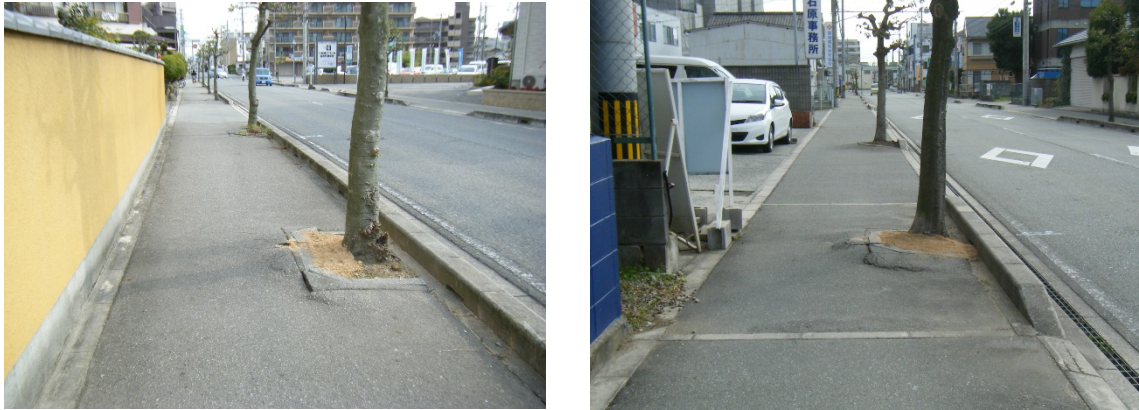
写真 5-4 植栽により根上がりした歩道
