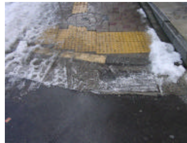
写真 2-1-5 柵蓋上が凍結し滑りやすくなっている事例
