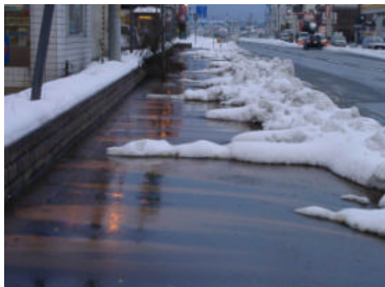
写真 2-1-4 横断勾配の急な区間の例(散水消雪)
