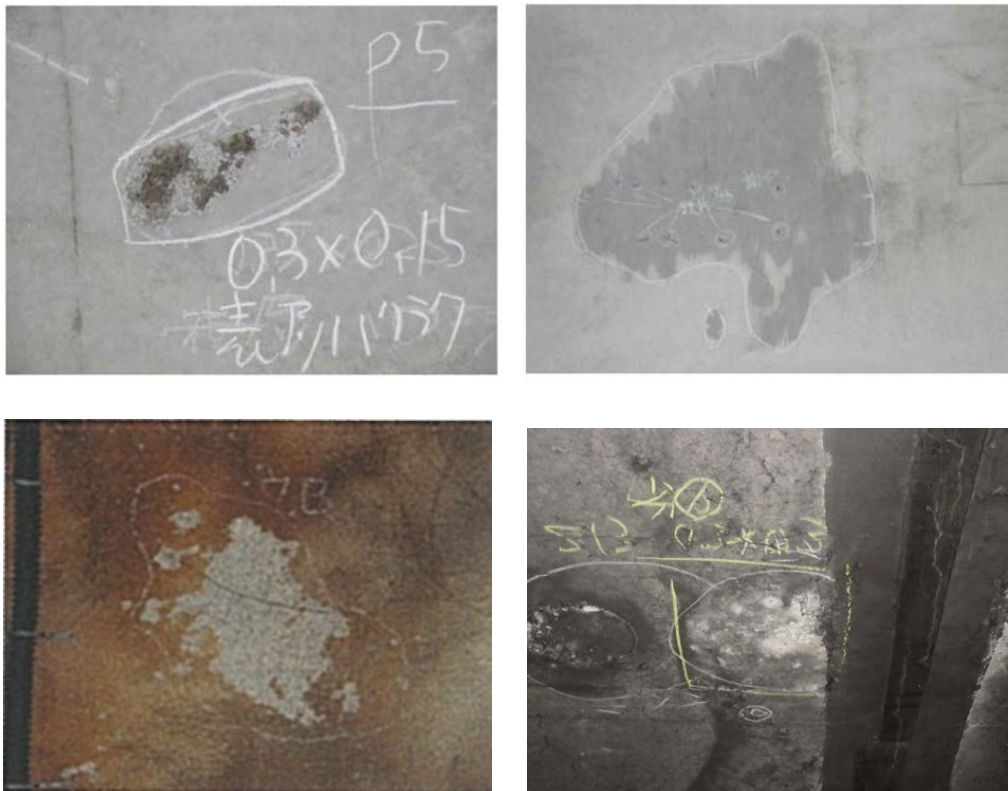
付写真-1.4.2 覆工コンクリートが変色している例 (うき・はく離を伴う例)
