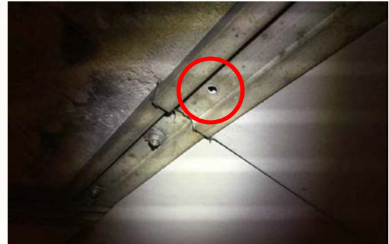
付写真-1.4.6 導水樋の止め金具が脱落した例
