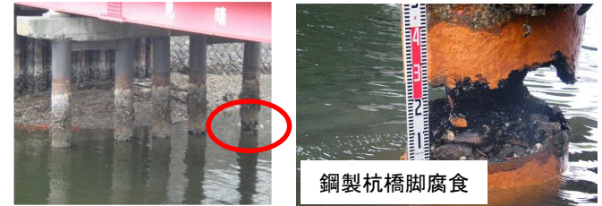
【重大な損傷の事例(橋梁)】
