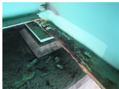
写真 15 下フランジ部の腐食（再発）
