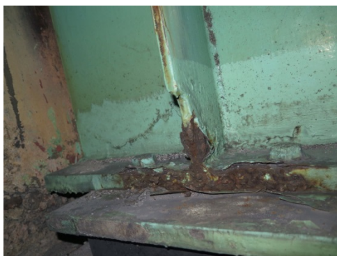
写真 14 支承部 腐食状態（再発）
