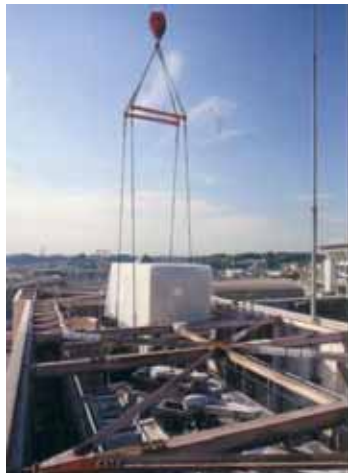
(屋上へのコージェネレーション機器の導入)
