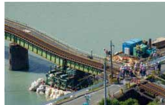
豪雨で橋脚が流され復旧工事が続くJR紀勢線・赤羽川鉄橋(6日、紀伊長島町で、本社ヘリから)
