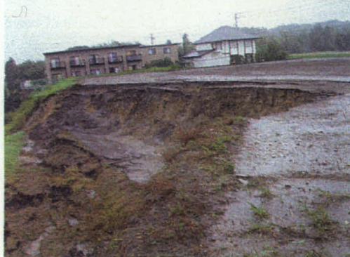
○未整備地域の災害発生状況
