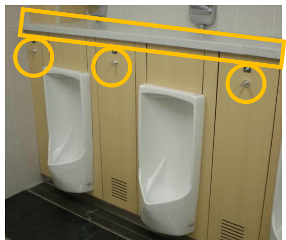
小便器の横に設置される例
