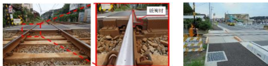
レールフランジの緩衝材
