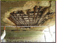
内部の鉄筋が露出した橋梁
