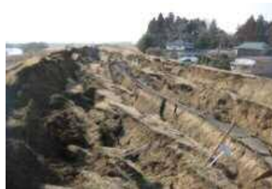
河川堤防の崩壊(鳴瀬川)
