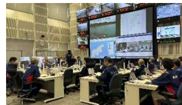
防災センター
