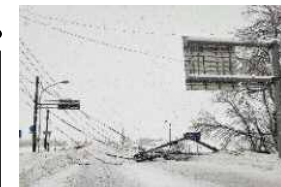
電柱の倒壊状況
