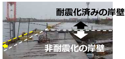
東日本大震災で被災した一般岸壁と耐震強化岸壁(仙台塩釜港)
