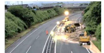
4車線のうち、土砂崩れの被害のない2車線を活用することで、迅速に通行を確保
