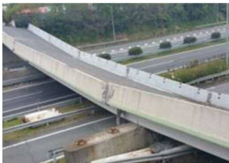
九州自動車道をまたぐロックンブライド橋脚の落橋 (県道小川嘉島線・府領第一橋)
