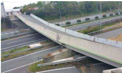
緊急輸送道路上の橋梁の崩落
