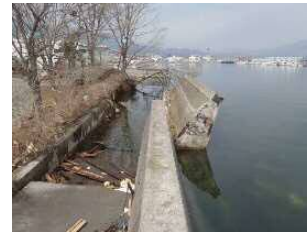
被災した海岸堤防(大船渡港海岸)
