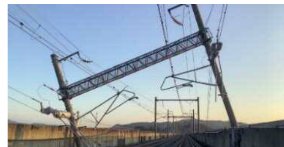
東北新幹線 電柱傾斜(令和4年3月)
