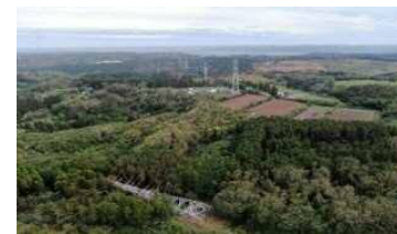
台風第15号(千葉県)の際に倒壊した鉄塔
