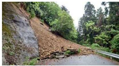
たかやすったせん (一)高屋出田線沿い法面崩壊 (石川県珠洲市若山町)
