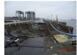
岸壁の被災(鹿島港)
