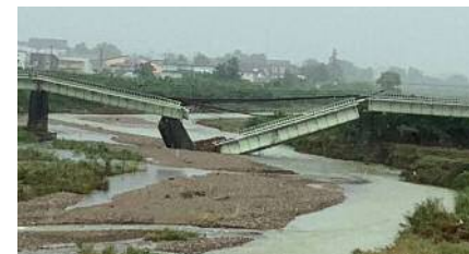
橋梁倒壊(磐越西線)
