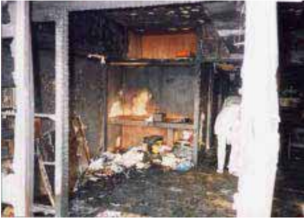
写真 4 - 7 火災現場 火元住戸内
