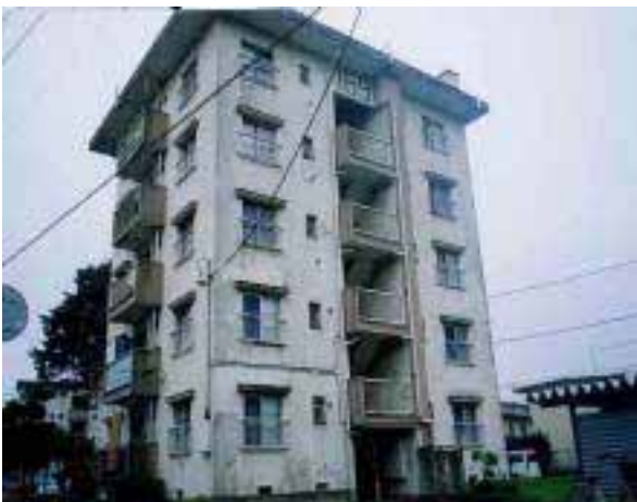
写真4-4 外壁補修施工前
