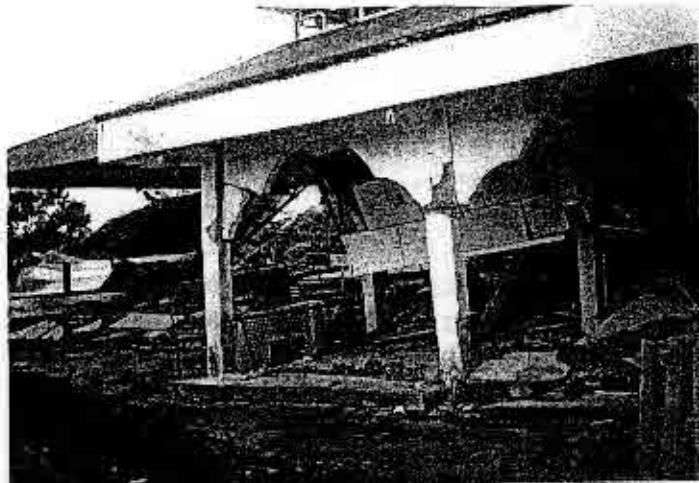
写真9 被害を受けたRC造によるモスク (大破)
