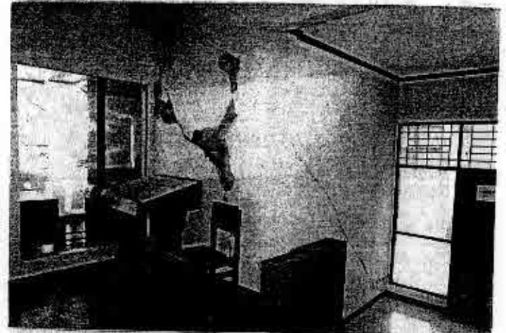
写真 7b 同建物のれんが壁のせん断破壊
