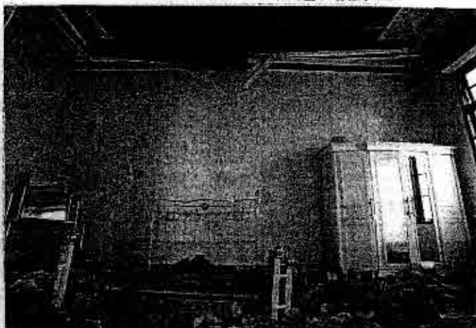
写真12 住宅内部の上部のれんか壁の崩落
