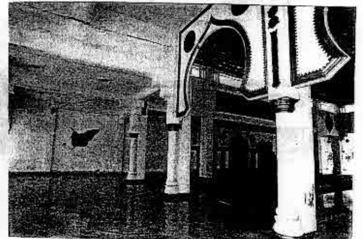
写真 8b 同建物のインフィルのせん断破壊
