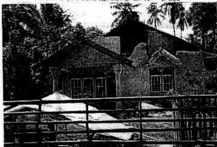
写真11 平屋建て住宅のれんか壁の崩落
