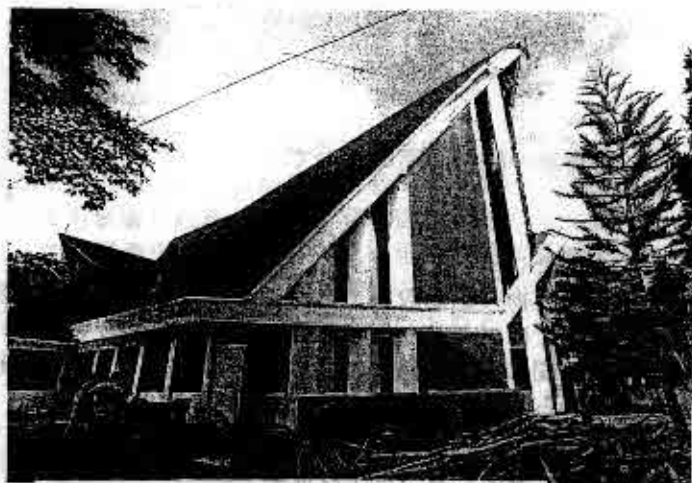
写真10 尖塔部分が崩落したRC造の教会
