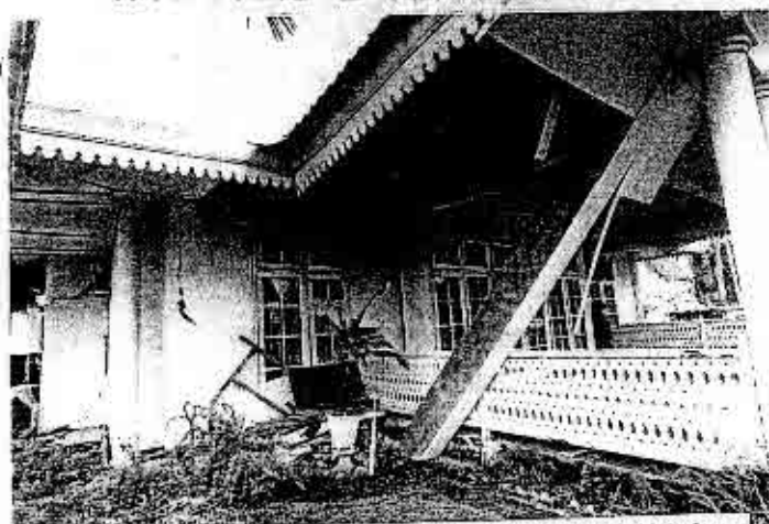
写真15 平屋建て住宅の玄関廻りの梁崩落(定着なし)
