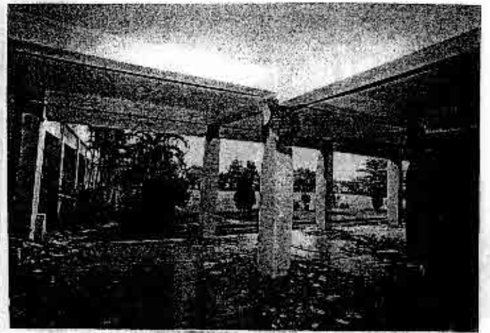
写真 1b 同建物のエントランスの柱頭の座屈
