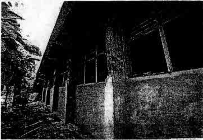
写真 2a 柱がせん断破壊した RC 造 2 階建て小学校(解体)
