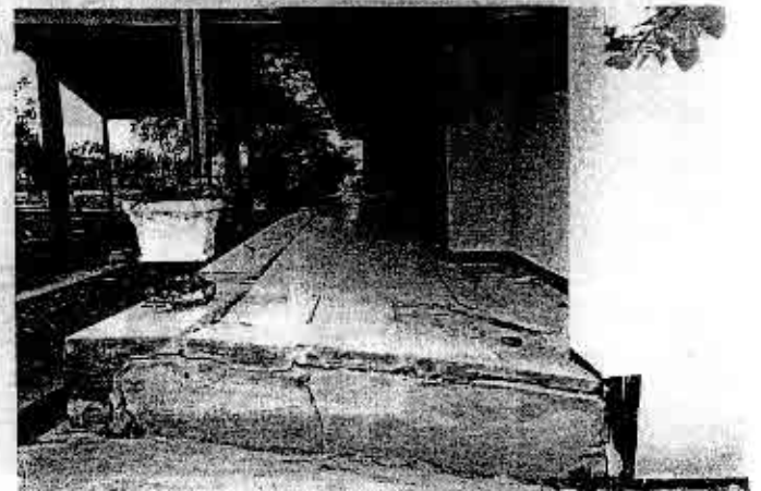
写真 4b 同建物の 1 階廊下部の沈下
