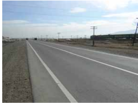
ウランバートル市南部産業道路 (日本の無償援助で建設中)
