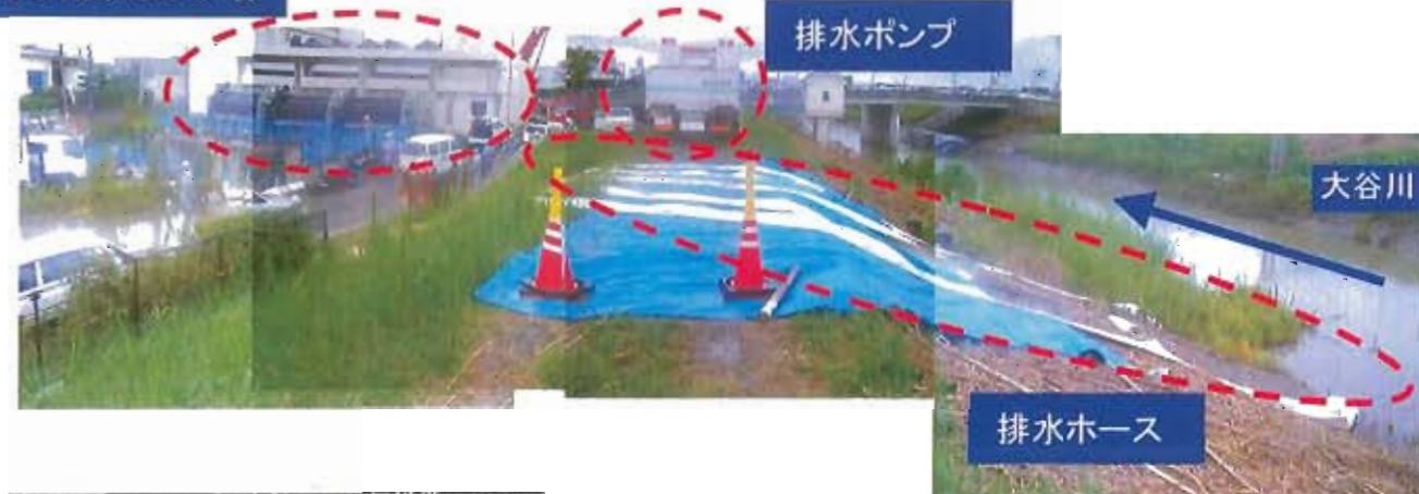
大谷雨水ポンプ場
