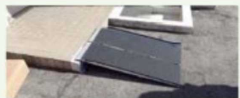
車いす用の段差解消スロープ
