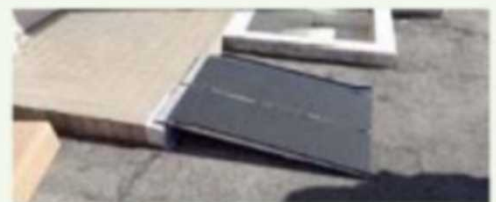
車いす用の段差解消スロープ
