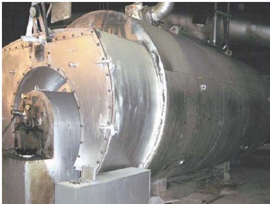
ボイラーの保温材
