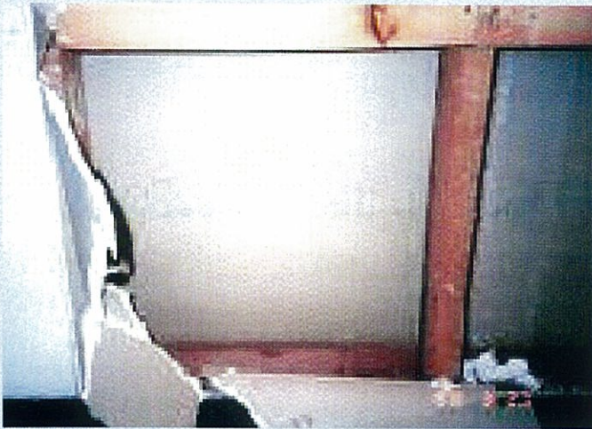
砒素・カドミ含有石膏ボード
