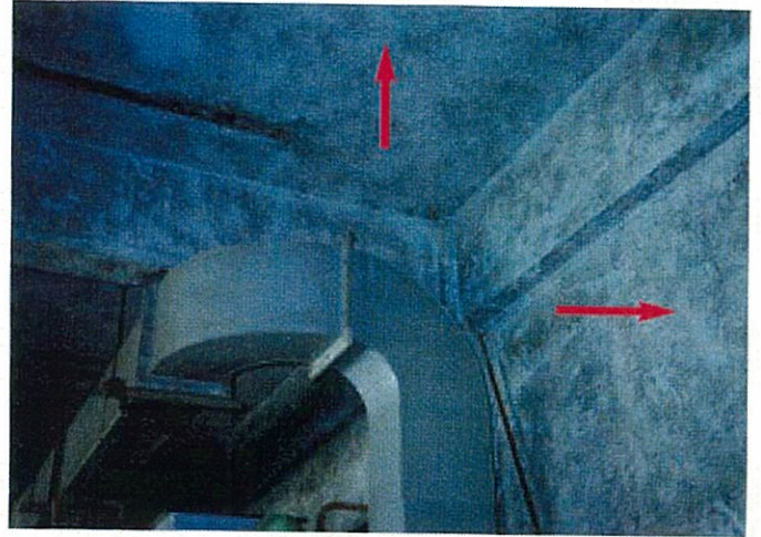
吹付アスベスト・石綿含有吹付ロックウール (吸音用)
