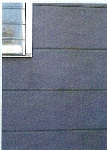
石綿セメント・サイディング
