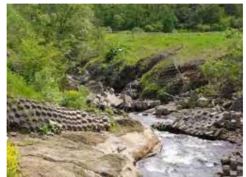
川底が削られた河川
